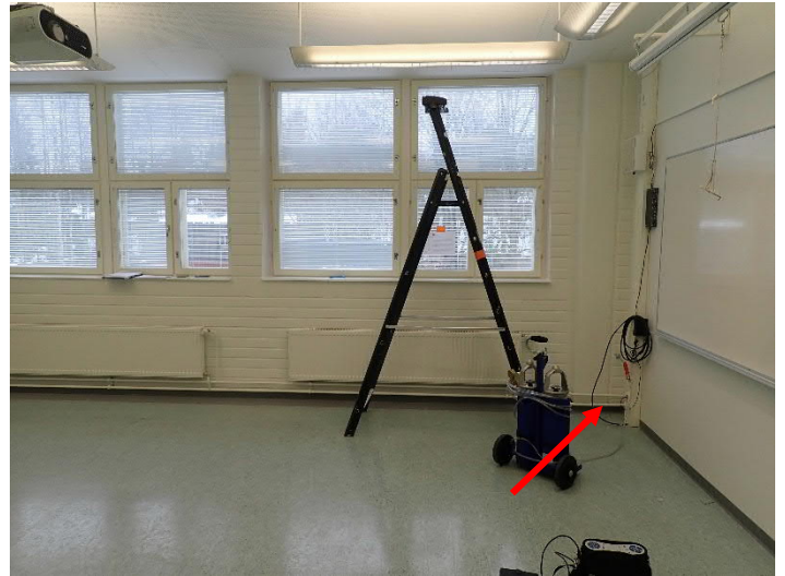
Kuva 5: Merkkiaineen vuotokohta tilassa 203.
