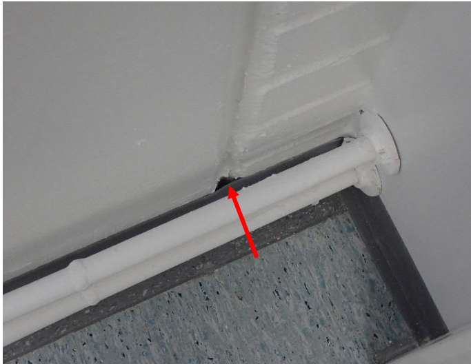
Kuva 4: Merkkiainetta vuoti muovimaton ylösnoston takaa pilarin ja seinän liitoksessa.
