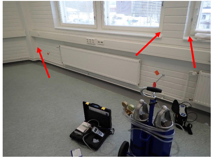
Kuva 2: Tilassa 201 havaitut merkkiaineikaasun vuotokohdat.
